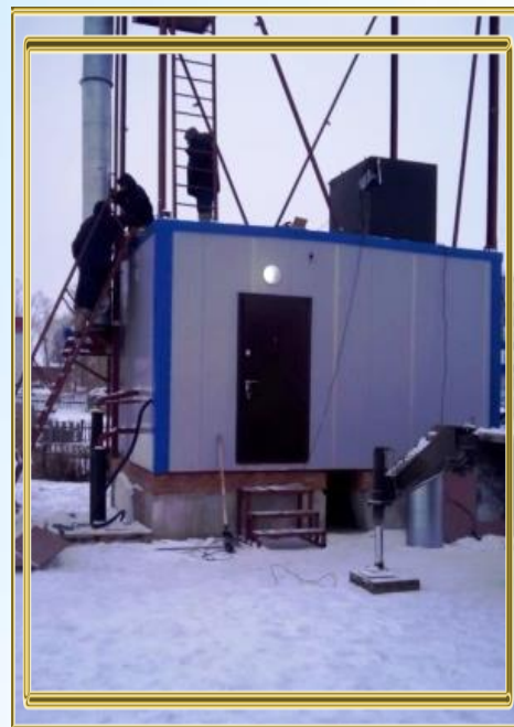
Котельная в г. Купино
